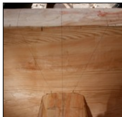
Oppmerking. Øvre del av svill i langvegg
