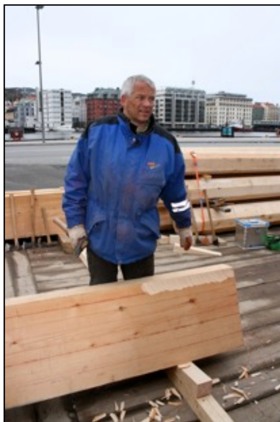
Svillen er merket opp for sprettelging Foto: Bjørn Systad
